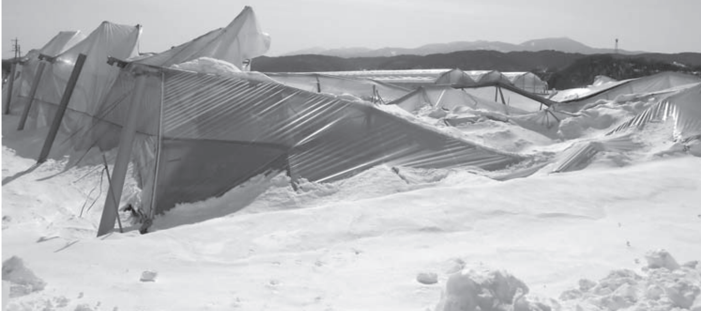
倒壊したパイプハウス
