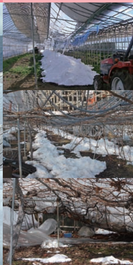
2月の豪雪による被害状況
