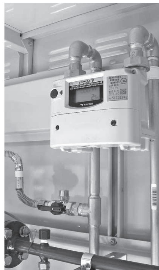
ガス漏れ監視設備(通称／モレケン)
